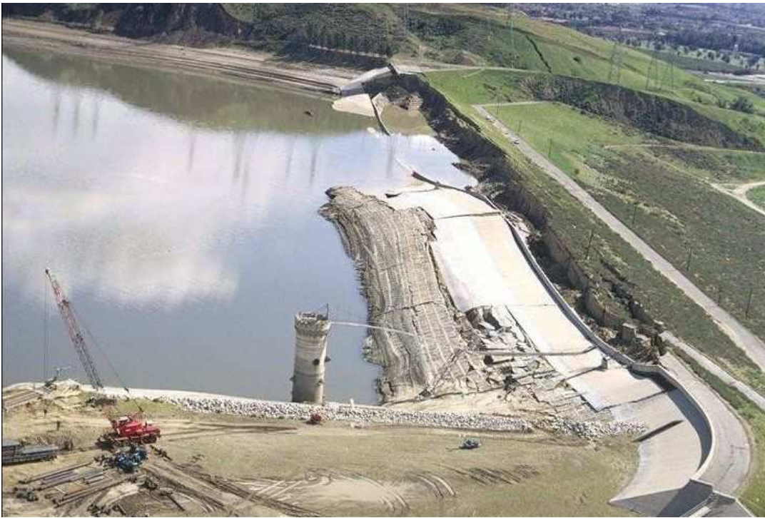
Lower San Fernando barajında San Fernando depremi, (1970) sırasında akma nedeniyle göçme
