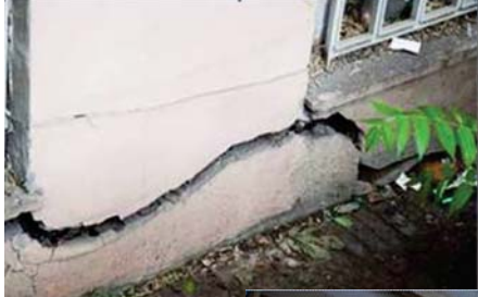
Marmaray ve İSKİ Tünel çalışmalarında Cerrahpaşa Tıp Fakültesi ve Çevrede Oluşan Çatlaklar.
