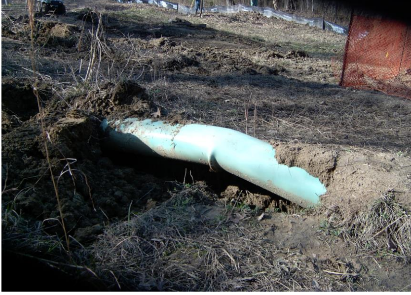
Şev içinde (veya şev üzerinde) deforme olmuş borular
