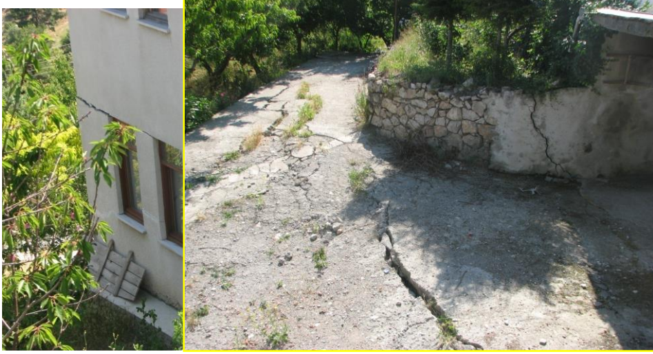
Binalarda, istinat duvarlarında çatlamlar
