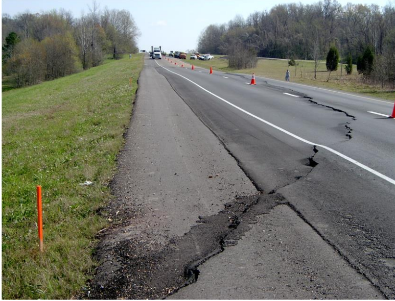
Yol kaplamalarında çatlaklar (heyelan çatlağını asfalt çatlağından nasıl ayırırız?
