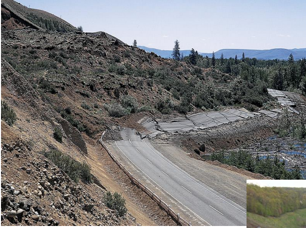
Yol kaplamalarında çatlaklar
