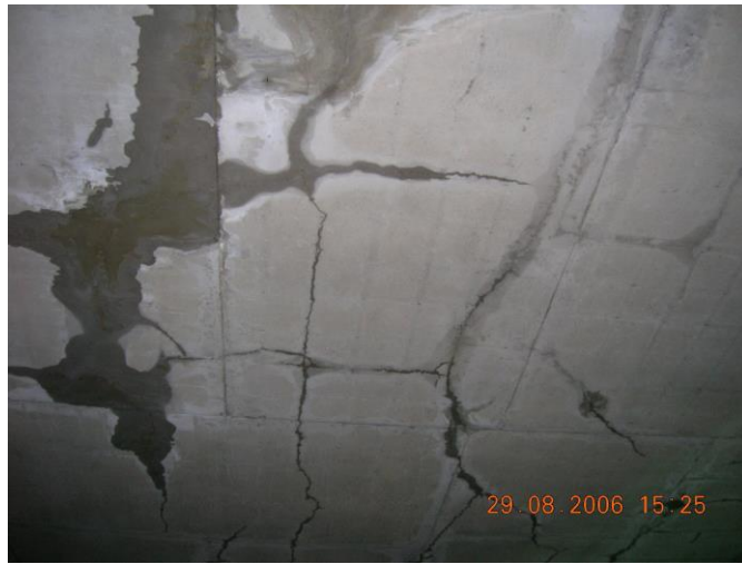
Resim 3b. Döşeme Plastik Rötire Çatlağı (Alttan görünüş)
