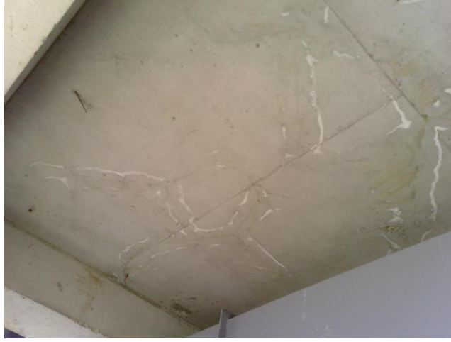
Resim 3a. Döşeme Plastik Rötire Çatlağı (Alttan görünüş)
