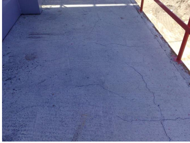
Resim 2 . Döşeme Plastik Rötire Çatlağı (Üstten görünüş)
