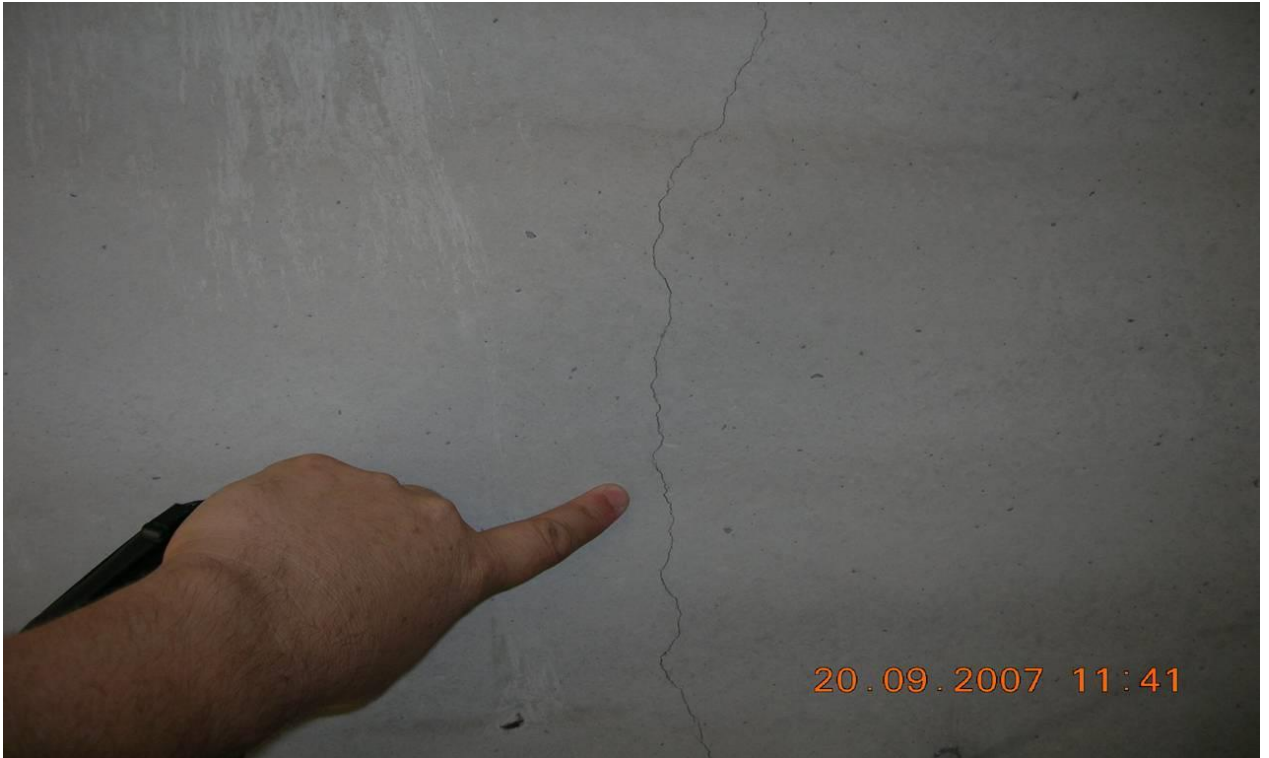
Resim 5a. Perde çatlağı
