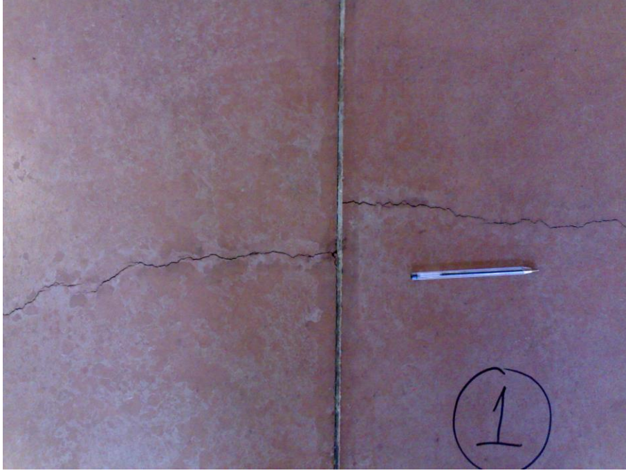
Resim 7: Döşeme kaplamasında beton çatlağı
