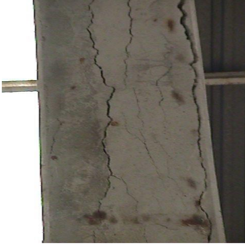
Resim 15. Donatı korozyonu çatlağı
