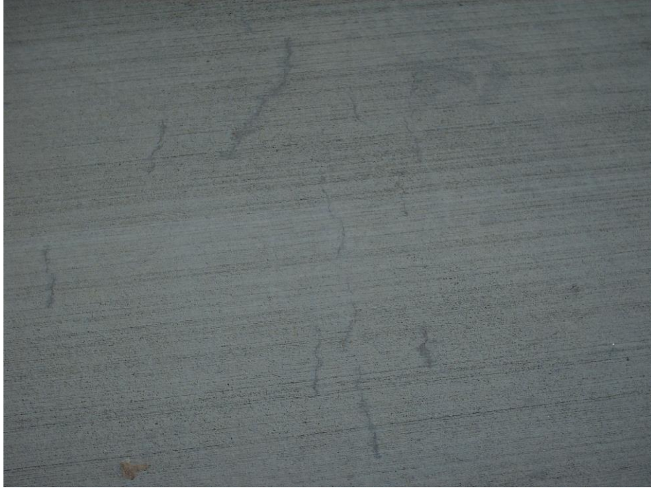
Resim 4. Zemin Betonunda Plastik rötre çatlağı
